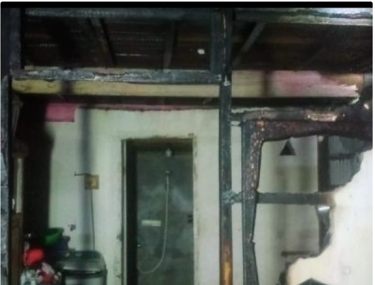
Bagian dapur rumah milik warga Bungi, desa Lalabata, kecamatan Tanete Rilau atas nama Rusli terbakar akibat tabung gas meledak
